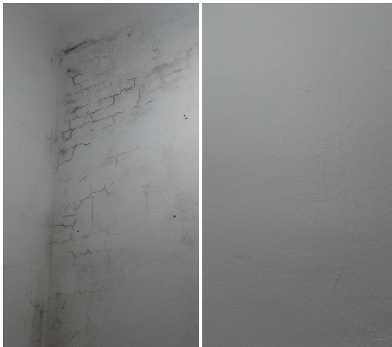
Fig 2 i 3. Humitats de condensació (esquerra) Presència d'elements biològics ABANS de la inspecció (dreta) Previ a la inspecció els inquilins van aplicar una pintura impermeable. Condensació encara present
