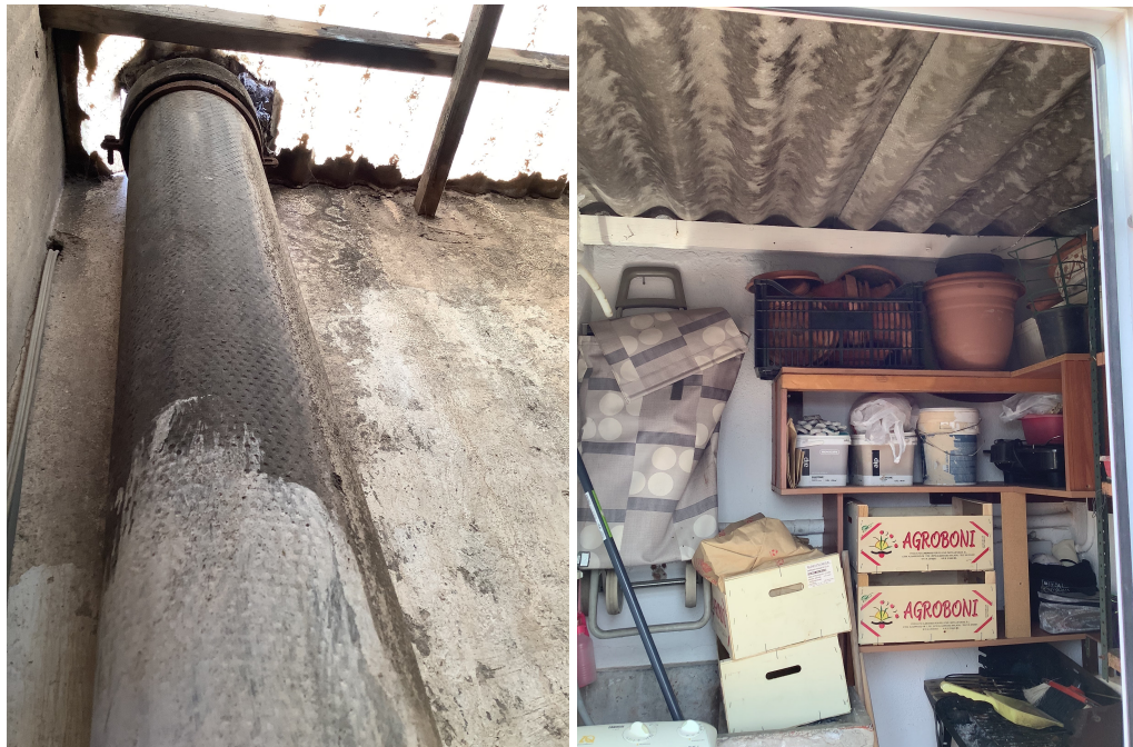
Fig 1. Amiant en conductes de ventilació i als trasters situats en coberta
