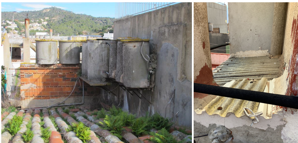
Fig 6 i 7. (esquerra) Dipòsits d'aigua de boca d'amiant. Fotografia proporcionada pel Ramón Muñoz. (dreta) Coberta de pati interior d'un edifici plurifamiliar del 1880 a Badalona
